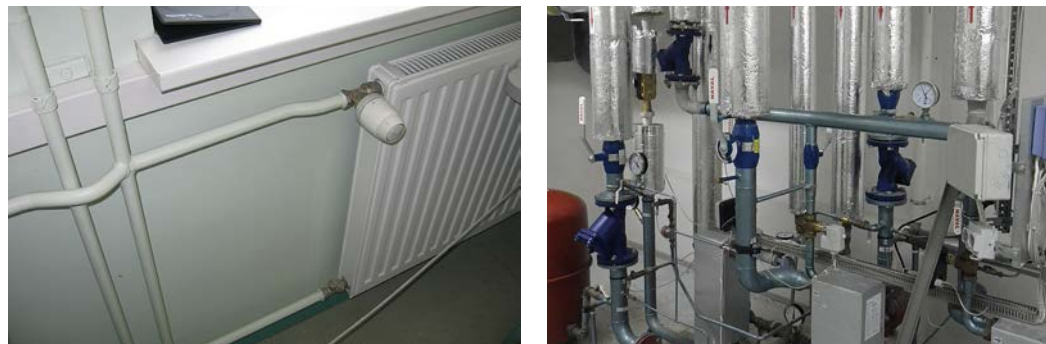
3.16. attēls. Uzstādītie termostatiskie vārsti (pa kreisi) un moderna apkures apakšstacija (pa labi)
