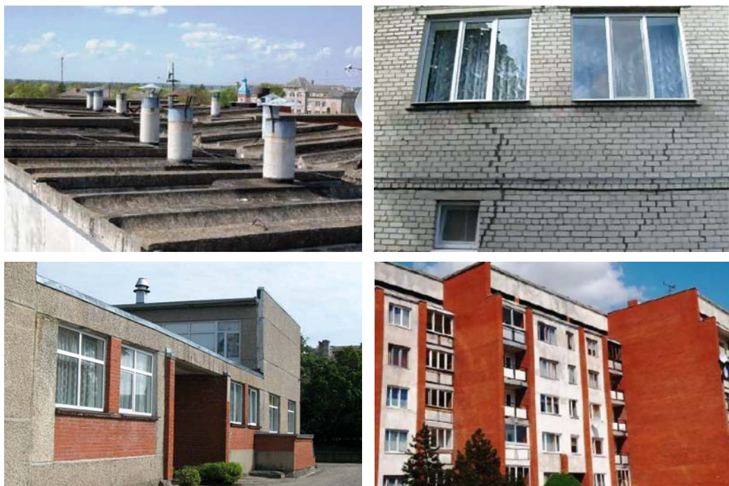
3.2. attēls. Ēku ierobežojošo konstrukciju stāvoklis pirms renovācijas
