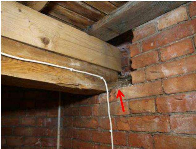
Foto 73. Puudulik hüdroisolatsioon torni puittalal müüritises
