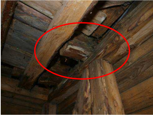
Foto 49. Niiskuskahjustus katusealune puittarindil
