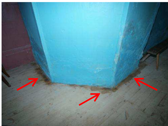
Foto 90. Märgunud põrandalauad põhjapoolses tiivas
