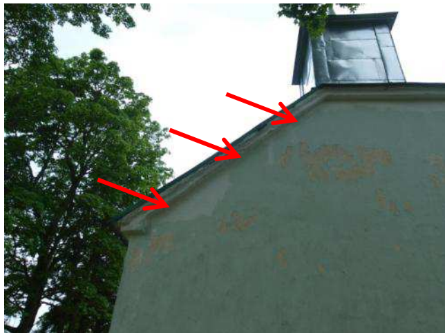
Foto 119. Niiskuskahjustus tagumisel otsaseina karniisil
