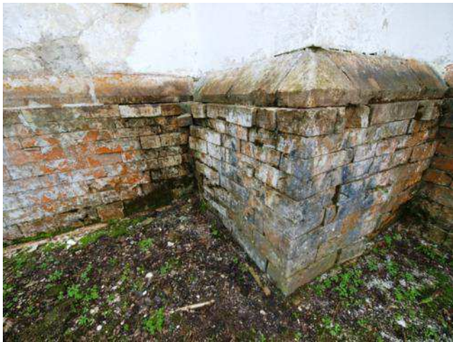
Foto 183. Niiskuskahjustusega kiriku sokkel
