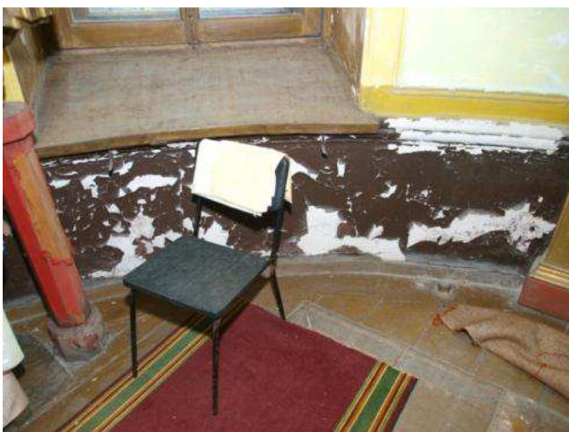
Foto 70. Kahjustatud värv siseseinal
