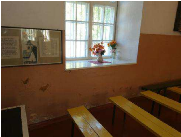
Foto 37. Kahjustatud värv kirikusaali seinal
