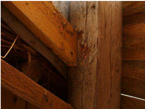
Foto 22. Tooneseplaste kahjustus katuse kandetarindi elementidel
