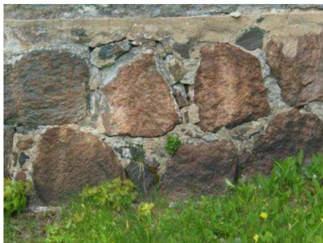
Foto 145. Irdunud vuugimört ja biokahjustus soklil
