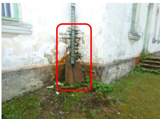
Foto 127. Niiskus-, külma- ja biokahjustused seinte alumistel osadel ja soklil
