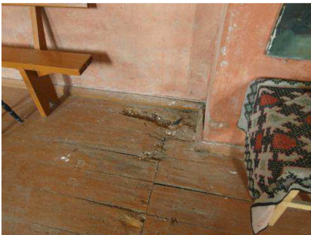
Foto 58. Mardika- ja niiskuskahjustustega kiriku põrand
