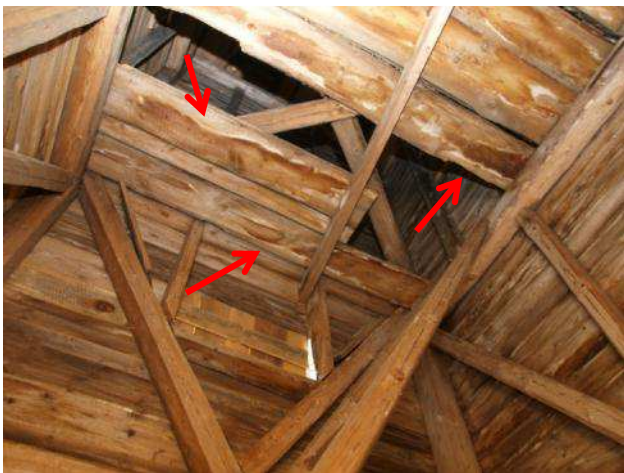
Foto 19. Niiskuskahjustused torni puittarinditel
