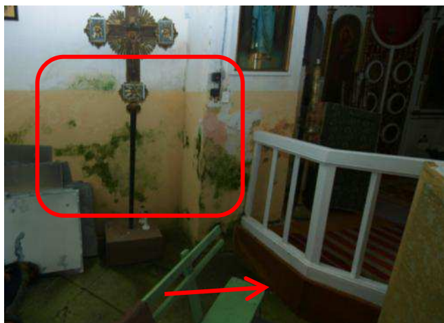
Foto 102. Vetikakahjustus kirikusaali kiviseinal
