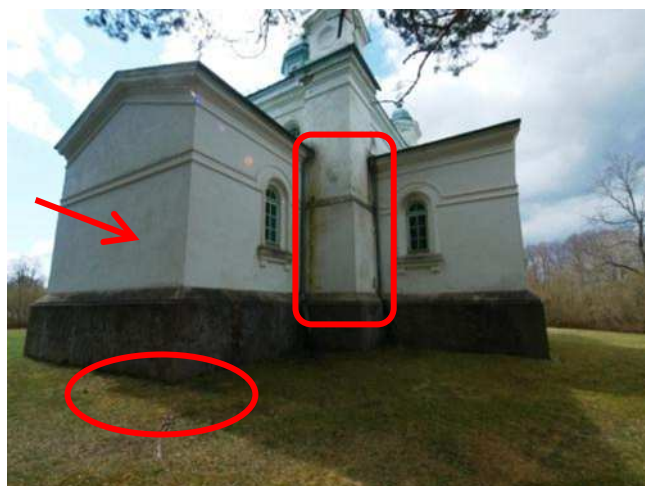
Foto 200. Lagunenud seinakrohv ja biokahjustused hoone kirdepoolsel küljel
