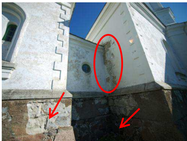
Foto 215. Niiskus- ja külmakahjustused seinal ja soklil
