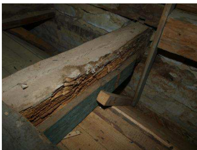
Foto 107. Seenkahjustusega kirikusaali vahelae tala
