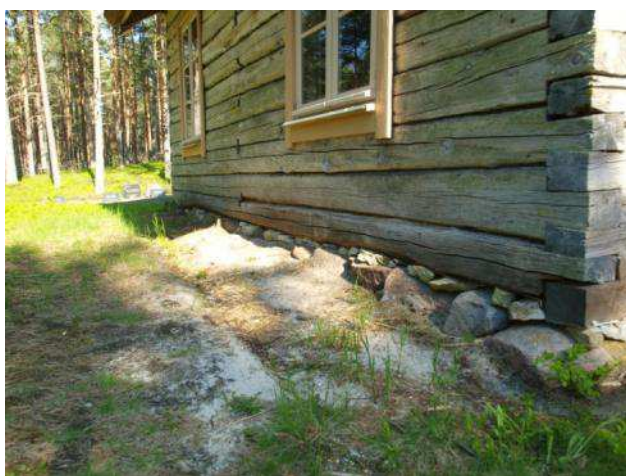
Foto 13. Kabeli sokli kahjustus
