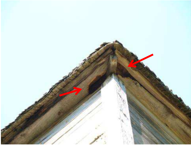
Foto 15. Kabeli torni räästa kahjustus
