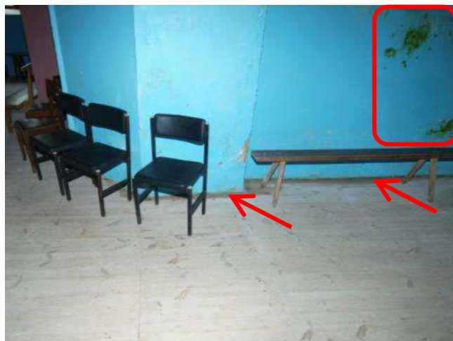
Foto 91. Vetikakahjustus ja märgunud põrandalauad põhjapoolses tiivas
