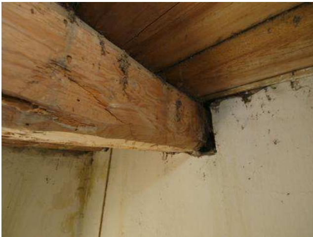
Foto 39. Puudulik hüdroisolatsioon torni puittal müüritises
