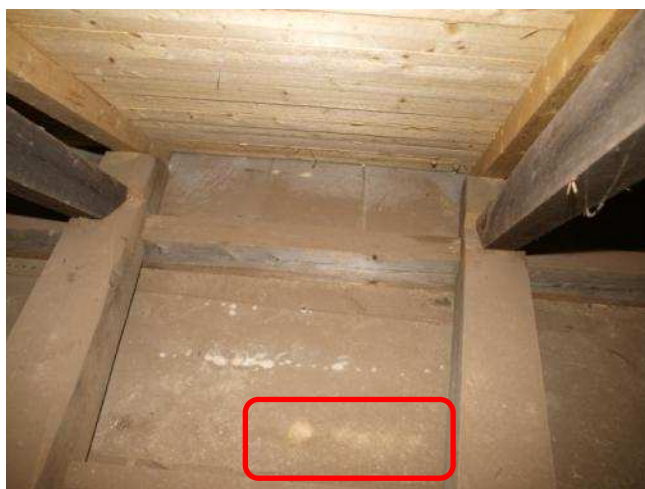
Foto 7. Majasiku näripuru pikihoone pööningul
