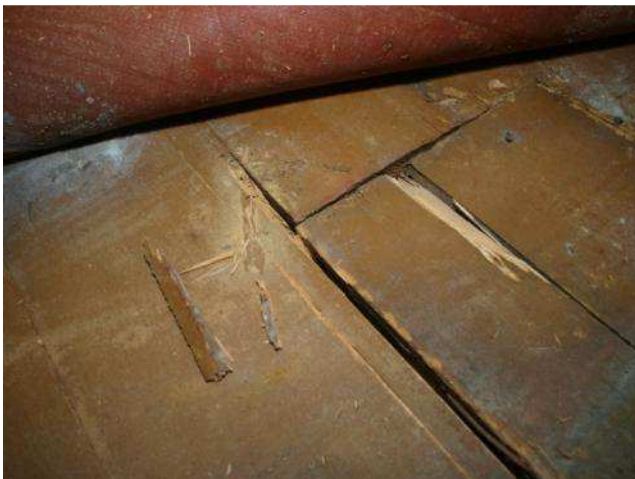
Foto 71. Mardikkahjustused ikonostaasitagusel puitpõrandal
