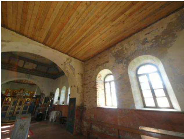
Foto 57. Kahjustatud värvja krohv siseseintel
