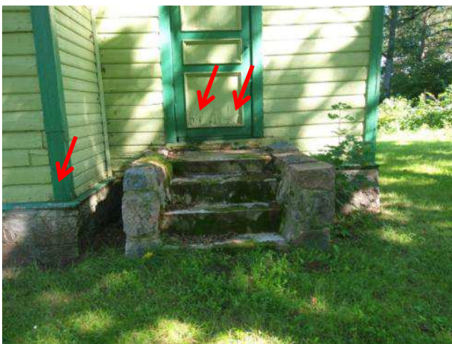
Foto 43. Kahjustatud värv seinal ja ukstel põhjapoolse sissepääsutrepi juures
