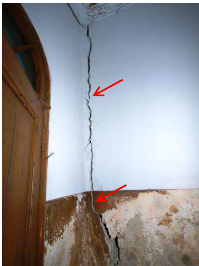
Foto 84. Lõunapoolse tiiva koda läbiv pragu
