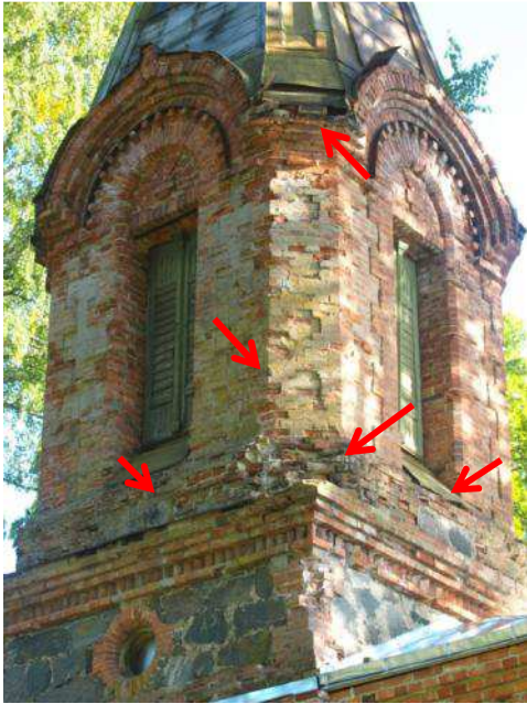
Foto 55. Niiskuskahjustused kirikutorni karniisi müüritisel
