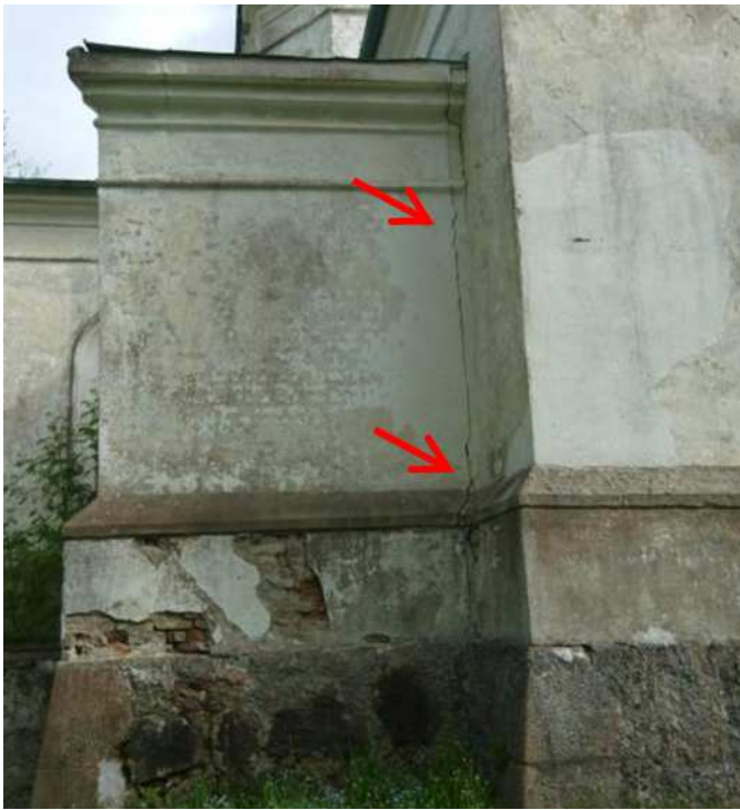
Foto 85. Lõunapoolse tiiva koda läbiv pragu
