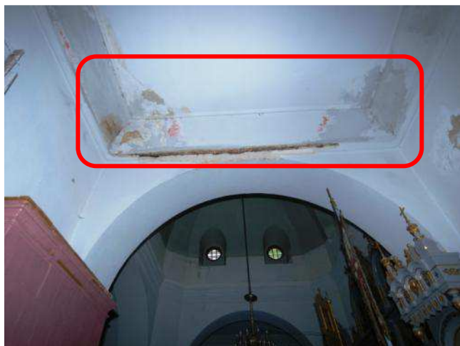
Foto 87. Ulatuslikud niiskuskahjustused lõunapoolse tiiva lael
