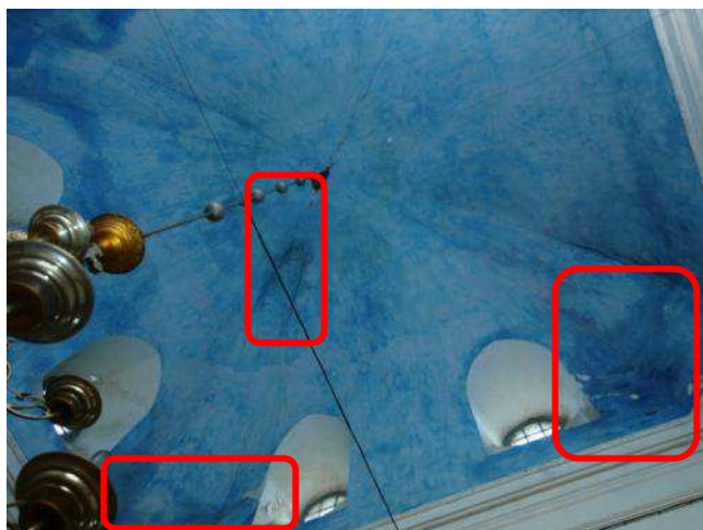
Foto 106. Niiskus- ja külmakahjustused keskmise kupli lael
