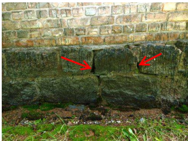
Foto 195. Puudulik mört soklikivide vahel
