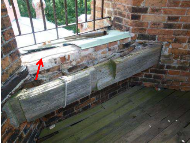
Foto 72. Puudulik veeplekk torni aval
