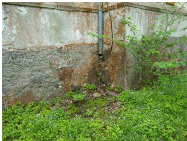
Foto 78. Niiskus- ja külmakahjustused hoone soklil
