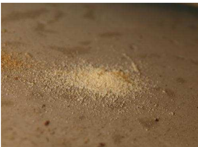
Foto 8. Majasiku näripuru pikihoone pööningul
