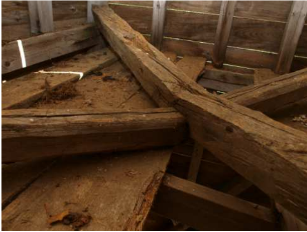
Foto 20. Pruunmädanikku tekitavate seente kahjustused torni puittarinditel. NB! Kiire tugevdamisega !
