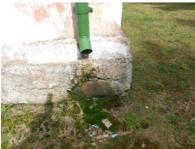
Foto 25. Vee- ja biokahjustus kiriku soklil
