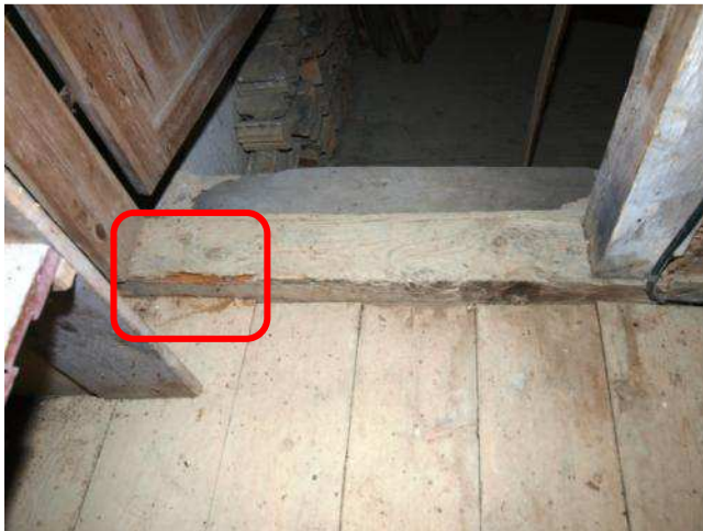
Foto 192. Mardikakahjustusega torni teise korruse ukse lävepakk
