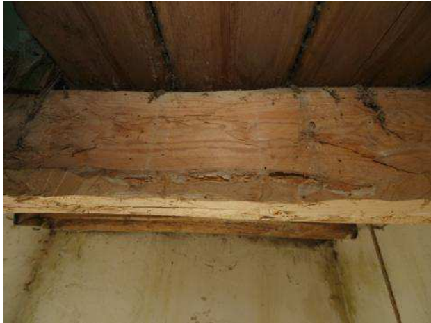
Foto 40. Mardikakahjustus torni trepi puittarindi elemendil, biokahjustus seinal
