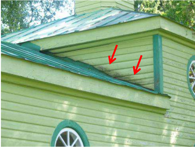
Foto 45. Niiskuskahjustus seina ja katuse liitekohas
