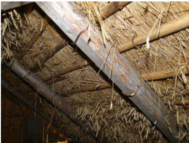
Foto 21. Siklaste kahjustus katusesarikatel
