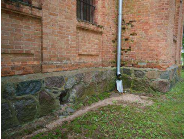
Foto 67. Niiskus- ja külmakahjustus seinal, biokahjustus soklil
