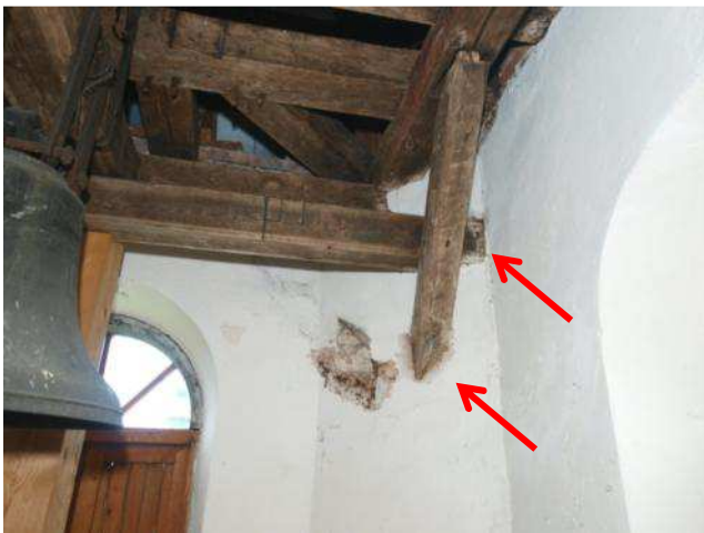
Foto 31. Niiskuskahjustus torni puitaladel
