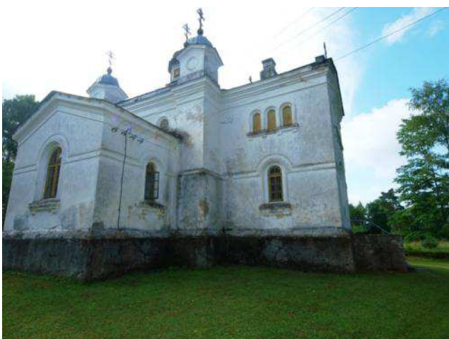
Foto 163. Niiskus- ja külmakahjustused kiriku seintel
