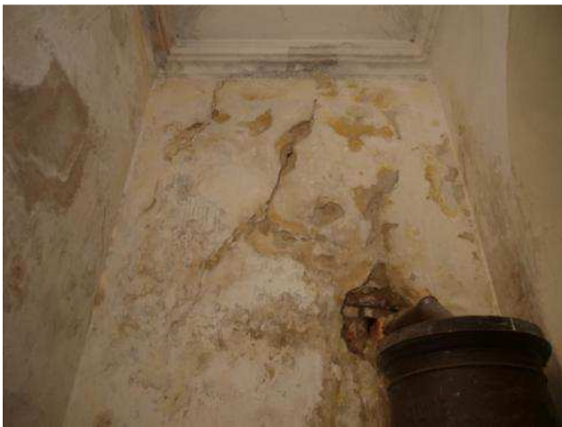
Foto 63. Kahjustatud värv ja krohv kiriku siseseinal
