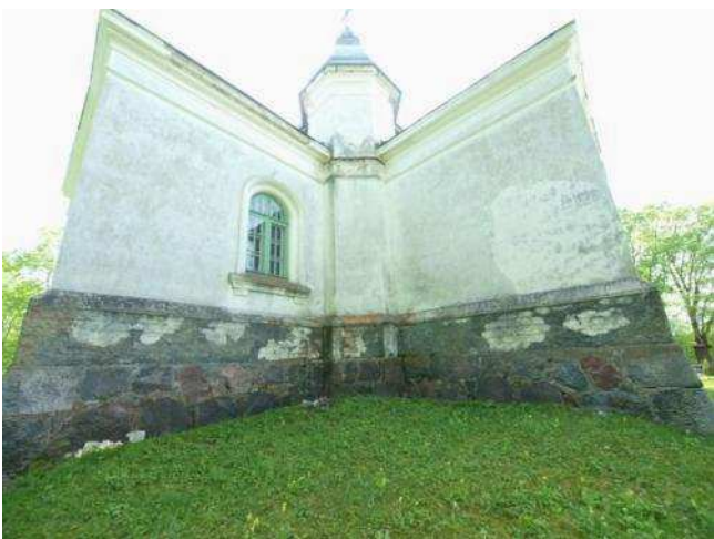
Foto 146. Niiskus-, külma- ning biokahjustused kiriku kirdepoolisel sisenurgal
