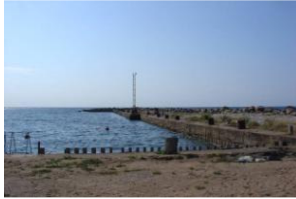
Joonis 2.1.4 Muul ja kaid vajavad rekonstrueerimist
