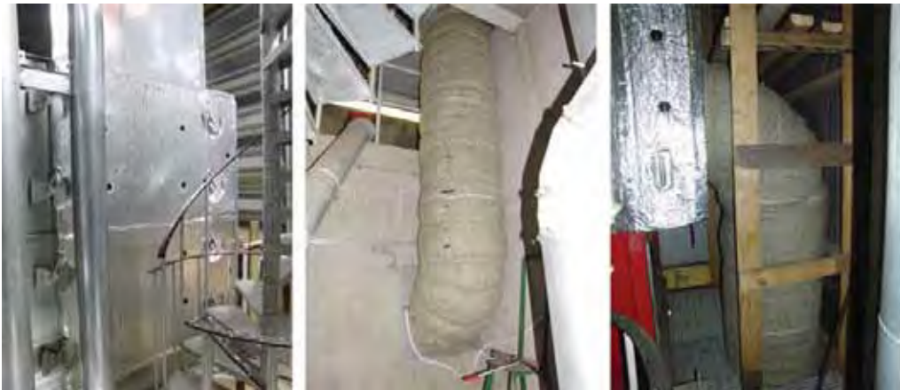
Kuva 3.18: Kuivurin kuumien peltipintojen eristys
