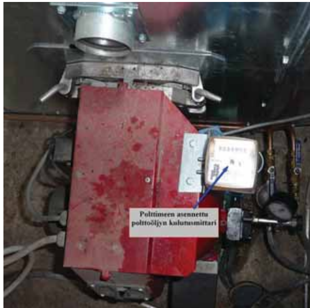
Kuva 2.6: Viljan kuivurin polttimeen asennettu kulutusmittari
