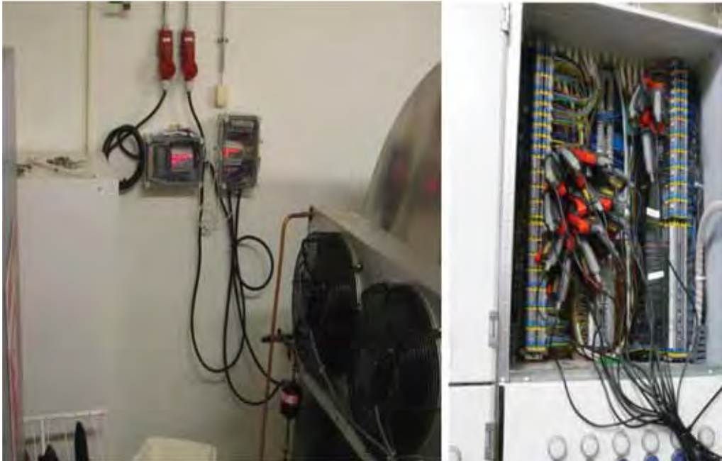
Kuva 2.9: Esimerkki sähköenergianmittauksesta, vasemmassa kuvassa on pistokkeen ja laitteen väliin asennettu energiankulutusmittarit, oikeassa kuvassa on koneen ohjaustauluun asennettu virtapihdit
