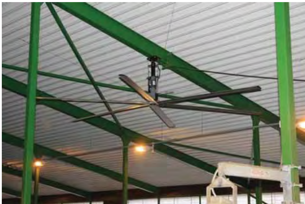
Kuva 3.30: Lypsyaseman odotustilan kattotuuletin
