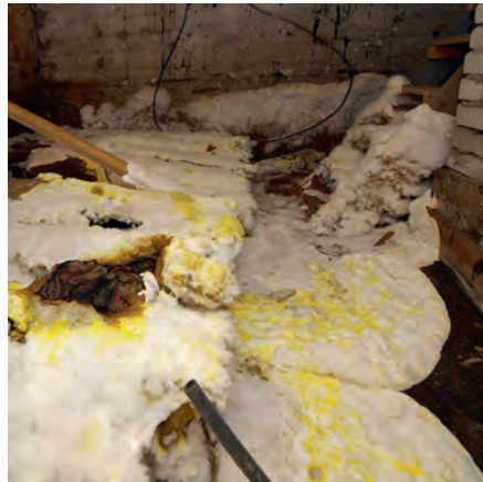
Foto 11. Seenkahjustus hoonealusel pinnasel.
