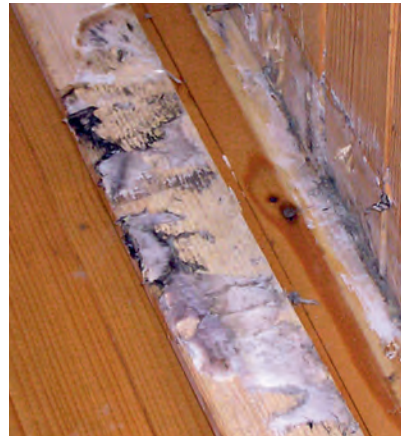
Foto 14. Seenkahjustus põrandaliistu taga.
