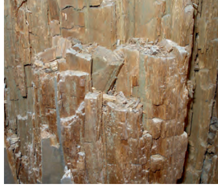
Foto 26. Pruunmädaniku poolt kahjustatud puit.
