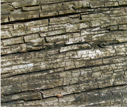
Foto 25. Pehmemädaniku poolt kahjustatud puit.
