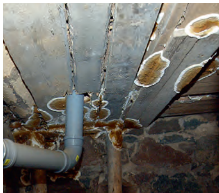
Foto 13. Seenkahjustus keldri laes torustiku ümbruses.
