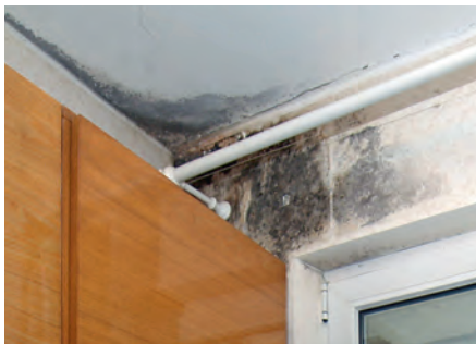
Foto 34. Hallitusseened korterelamu viimasel korrusel toa rõdupoolses välisnurgas.
