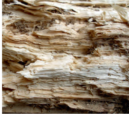
Foto 31. Valgemädaniku poolt kahjustatud puit.
