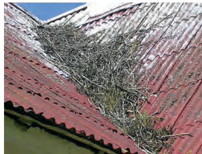
Foto 9. Hoone katusele neelukohta on kogunenud puitprahht.
