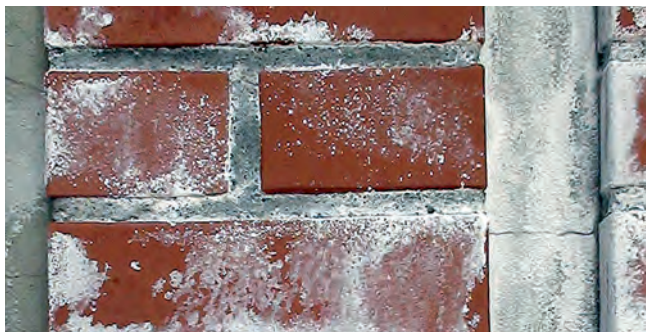
Foto 4. Soola- kahjustused seinal.
