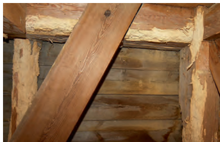
Foto 42. Ruhnu uue kiriku kahjustatud tornitarindid.
