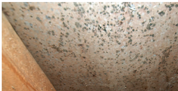
Foto 16. Hallitusseente kahjustusega katuse-tarindi element.
