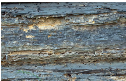
Foto 41. Siklaste poolt kahjustatud palksein.
