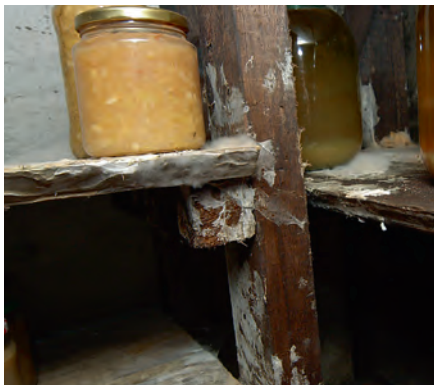
Foto 12. Seenkahjustus keldris puitriiulitel.
