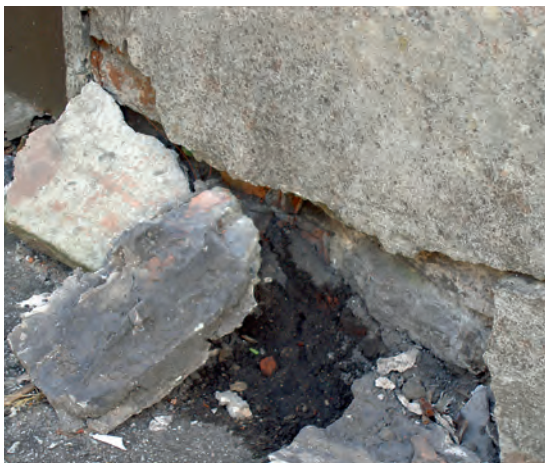
Foto 3. Vee külmumise tõttu purunenud sokkel.
