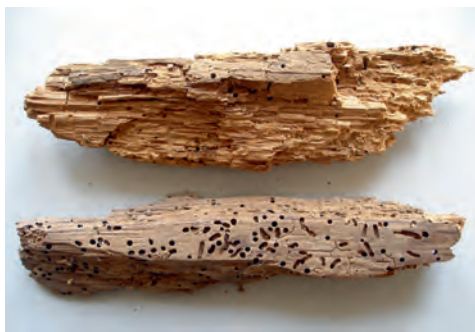
Foto 39. Tooneseplaste poolt tugevasti kahjustatud puit.
